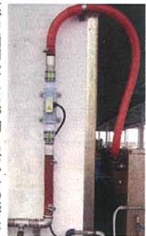
荷さばき場に設置した電解槽
